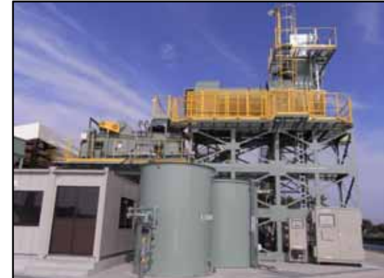
洗浄設備(重金属)
