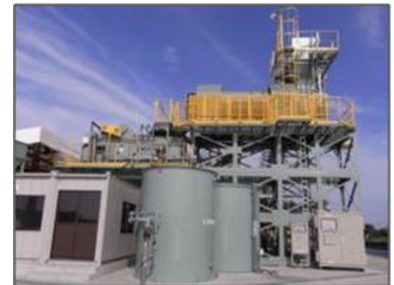
洗浄設備(重金属)
