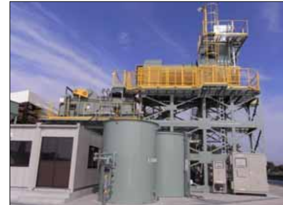
洗浄設備(重金属)
