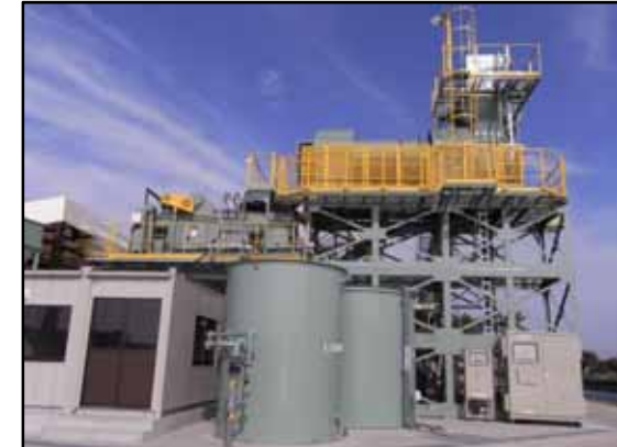
洗浄設備(重金属)
