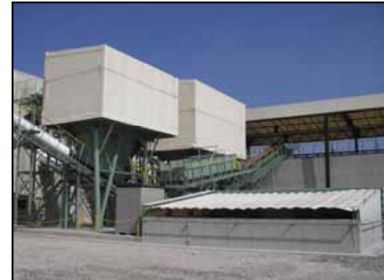
洗浄設備(重金属)
