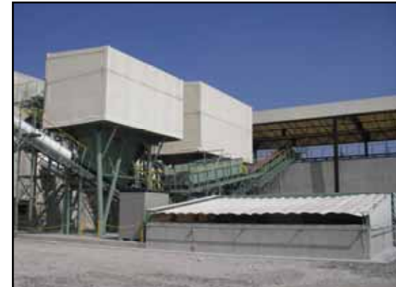
洗浄設備(重金属)
